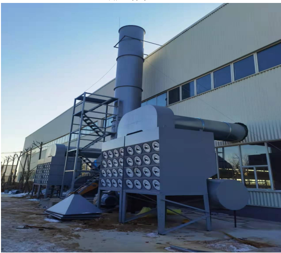
布袋除尘器+排气筒 P2-2
