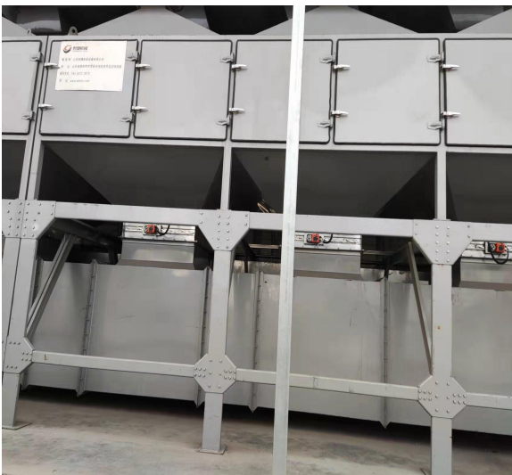
活性炭吸附/脱附-催化燃烧装置
